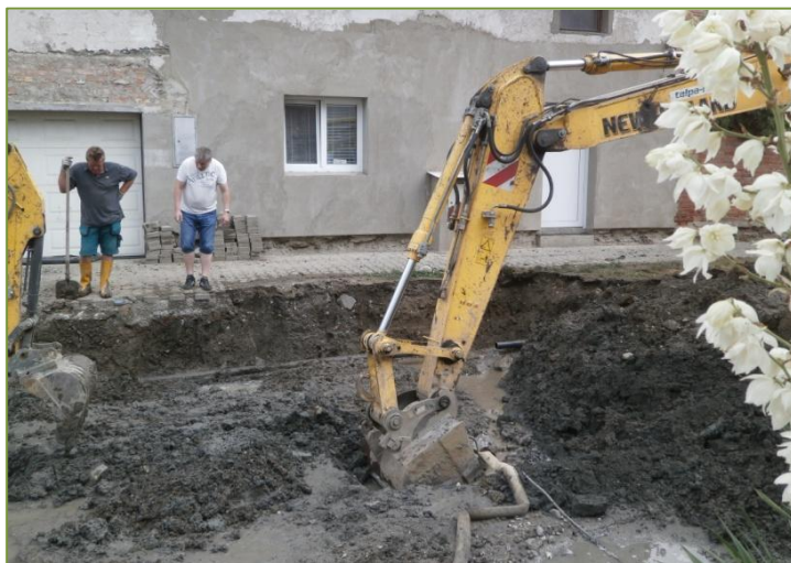
Výstavba kanalizace se několikrát projevila také přerušením dodávky pitné vody. Tato havárie nastala 9. července 2015 před domem č. p. 143.
