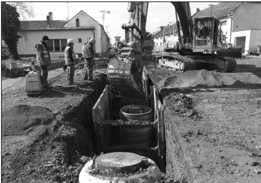
Jedna z čerpacích stanic byla vybudována na hřišti. Pozemek zde patří obci. V tomto místě bylo vybudováno napojení čerpací stanice na kanalizační řad. Šachta s poklopem, je ukončením pro přitékající splašky, které pod vozovkou tečou do čerpací stanice, a ve druhé začíná vyústěním z čerpací stanice odtok ve směru na Chropyni.
