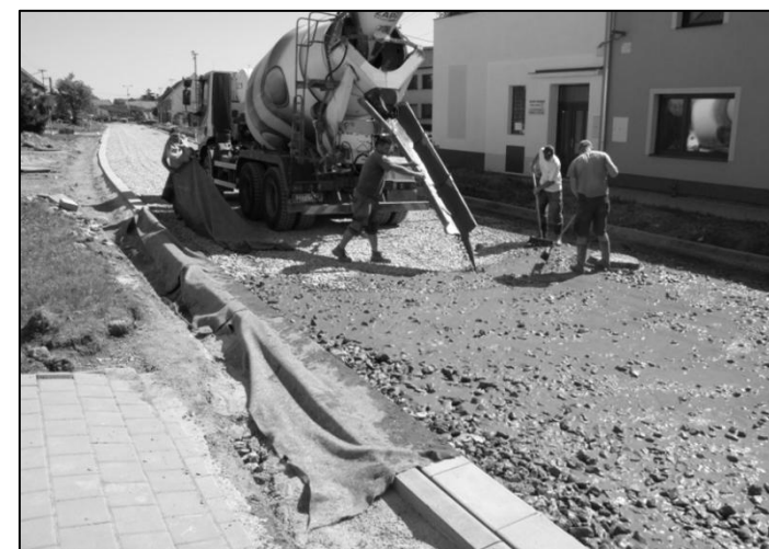
5. června 2015. Makadam firma zalila betonem, zaválcovala a na závěr byly položeny vrstvy živičných směsí.
