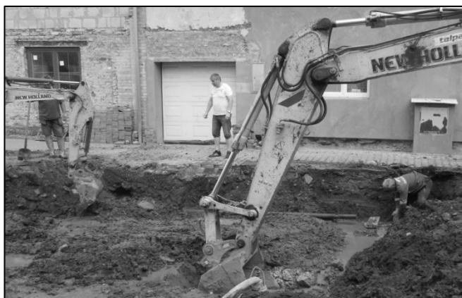
Výkopové práce byly také několikrát příčinou přerušení dodávky pitné vody do domácností. Na snímku oprava poškozeného vodovodního řádu před domem č.p. 143.
