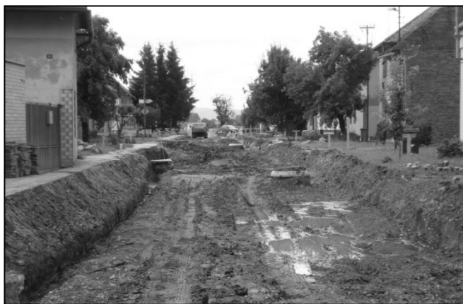
Rekonstrukce vozovky velmi komplikovala občanům jejich každodenní život. Přístup do domů ztěžovala značná hloubka výkopů a bláto.
